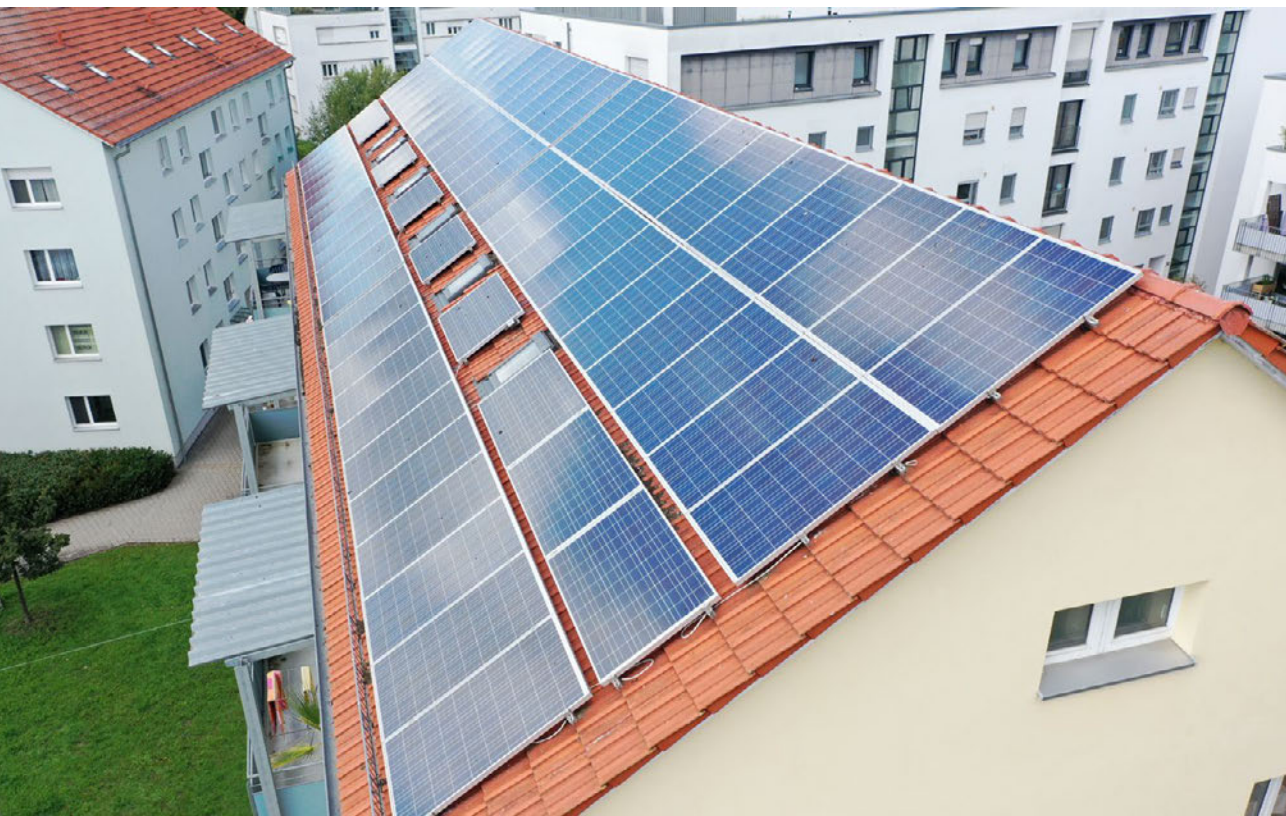
Photovoltaik in der Sedanstraße und im Grünen Winkel
